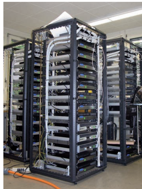
Rackbau bei der Kilchenmann Telematik AG
